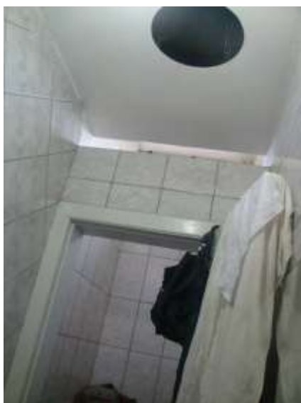
forro de gesso deverá ser reparado e a iluminação ajustada.
